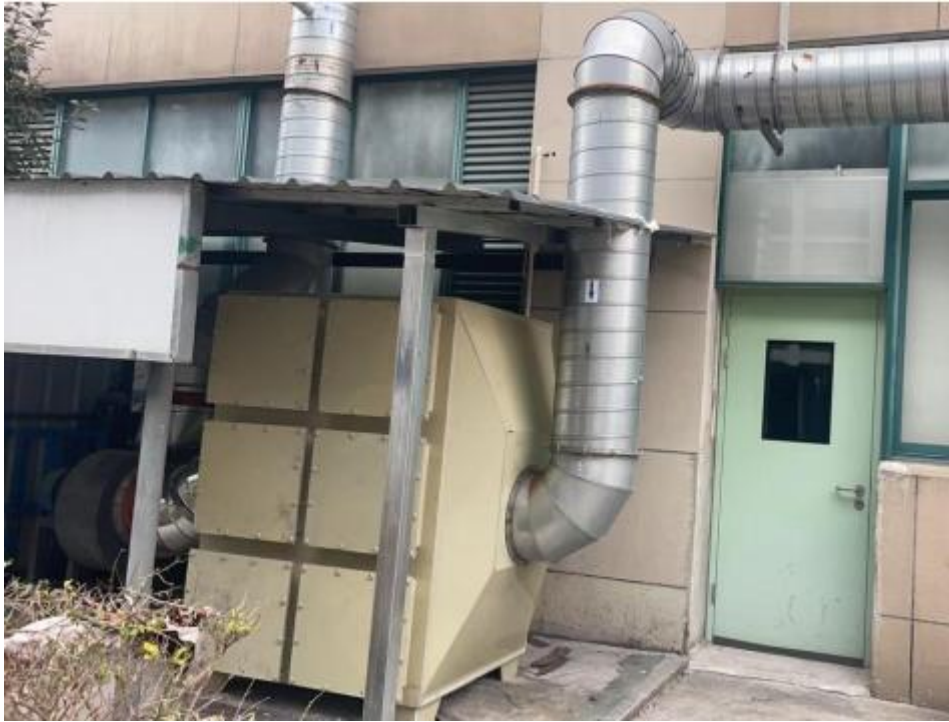
附图 1.1 废气治理装置（活性炭处理装置）
